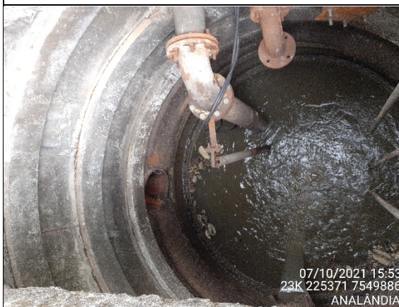
Foto 65: Estação Elevatória de Esgoto – poço da bomba de recalque. Destaque para altura do extravasor do efluente.
