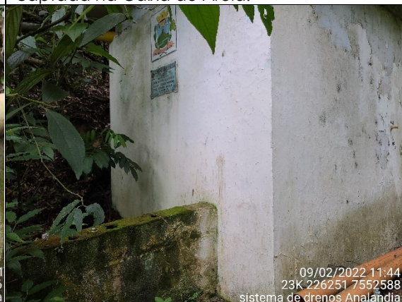
Foto 10: Caixa de Areia
