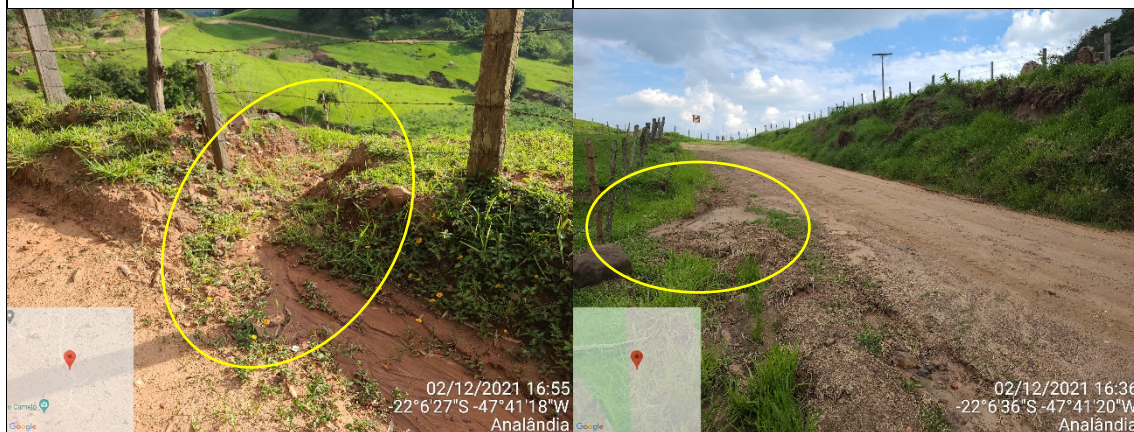
Foto 121: Caminho das águas pluviais – possível deflagrador da voçoroca.
