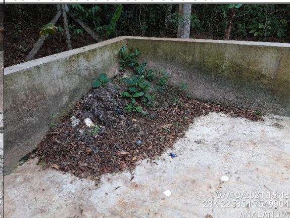
Foto 62: Estação Elevatória de Esgoto – local de armazenamento temporário de resíduos sólidos grosseiros retidos na grade.
