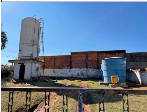
Foto 27: Captação e reservatórios do SAA Jardim Nova Esperança (Fonte: Prefeitura Municipal de Analândia).
