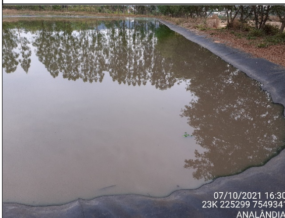
Foto 91: ETE - Assoreamento na borda próxima à saída de efluente da lagoa facultativa.
