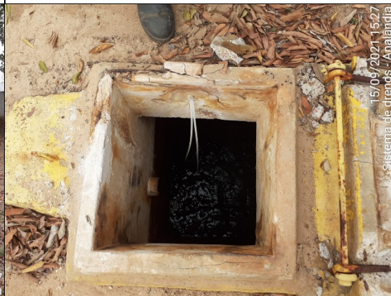
Foto 46: Posso de acesso e mangueiras dosadoras de flúor e cloro - SAA Drenos
