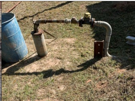
Foto 20: Laje Sanitária do poço 02 - SAA Jardim São Carlos. (Fonte: Prefeitura Municipal de Analândia)
