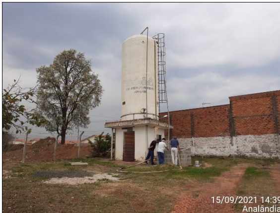
Foto 25: Reservatório de 55 m³ e casa de químicos – SAA Jardim Nova Esperança
