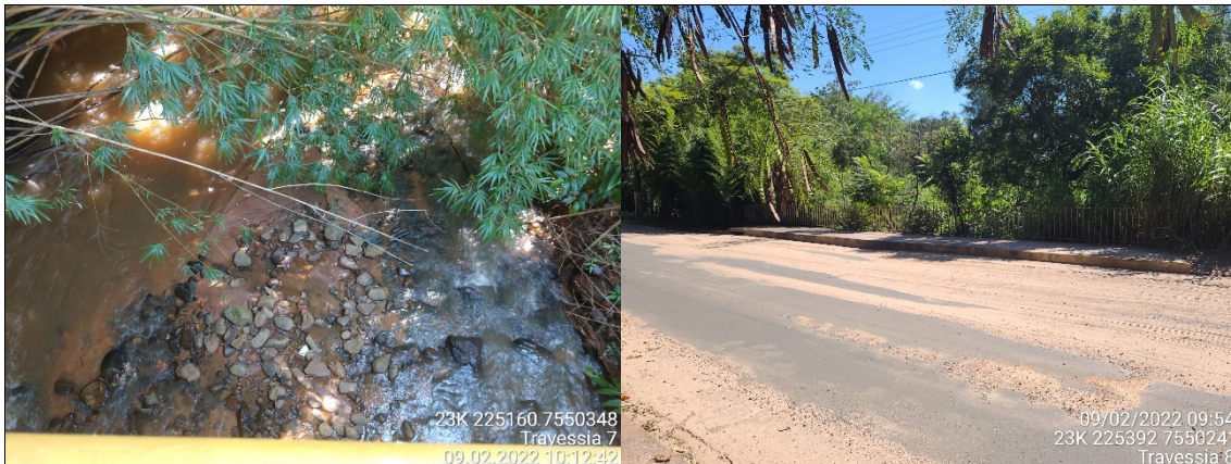
Foto 167: Travessia 7 - leito do rio (jusante) com destaque para banco de sedimento assoreado.
