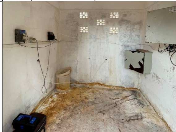
Foto 30: Bombas dosadoras de químicos e painel elétrico – SAA Nova Analândia (Fonte: Prefeitura Municipal de Analândia)
