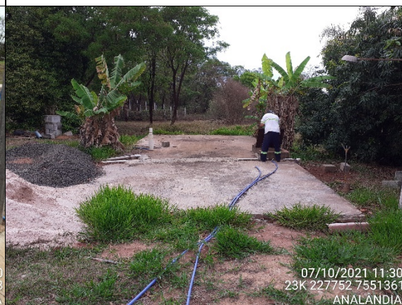
Foto 40: Reservatório enterrado de 100 m³ da ETA desativada e do Poço 07 - SAA Portal das Samambaias
