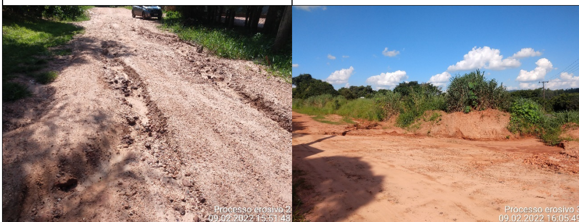
Foto 129: Processo erosivo na Rua D.
