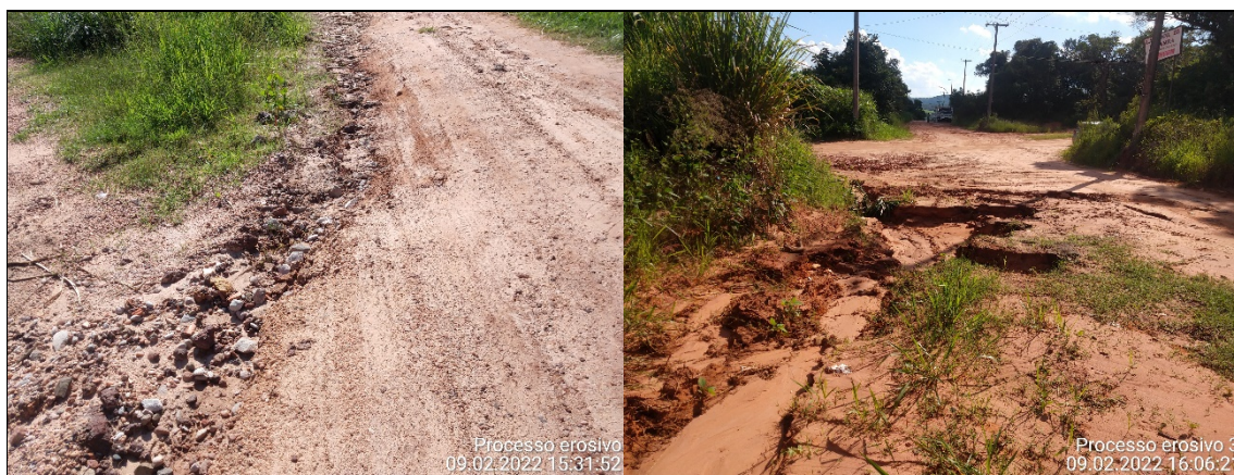
Figura 24 – Feição erosiva na Rua C, próxima à Cachoeira da Ponte Amarela.
