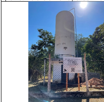
Foto 21: Poço 03, reservatório e casa de químicos do SAA Jardim Santana. (Fonte: Prefeitura Municipal de Analândia)
