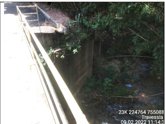
Foto 150: Travessia 3 – leito do rio e calha de água pluvial sem dissipador de energia
