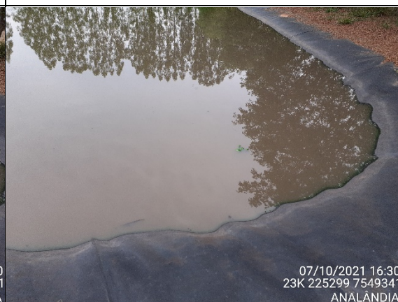
Foto 92: ETE - Assoreamento na borda próxima à saída de efluente da lagoa facultativa.
