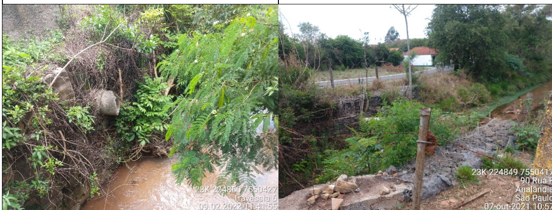
Foto 163: Travessia 6 - tubulação de lançamento de água pluvial sem dissipador de energia.
