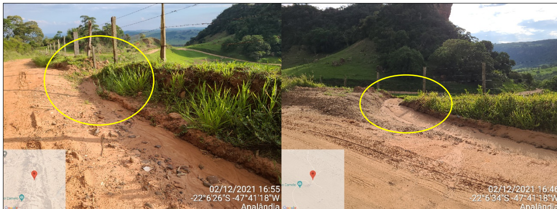
Foto 119: Caminho das águas pluviais – possível deflagrador da voçoroca.
