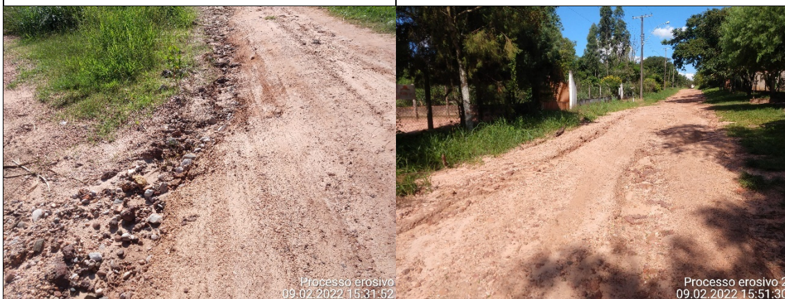
Foto 127: Processo erosivo na Rua C – próximo à Cachoeira da Ponte Amarela.
