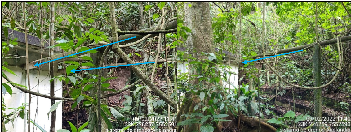
Foto 7: Chegada da tubulação de água captada na Caixa de Areia.
