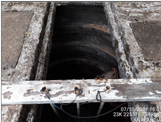
Foto 63: Estação Elevatória de Esgoto – poço da bomba de recalque.
