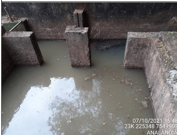
Foto 61: Estação Elevatória de Esgoto – entrada (direita) e saída (esquerda) da caixa de areia.
