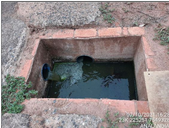
Foto 87: ETE - Caixa de saída do efluente da lagoa facultativa.
