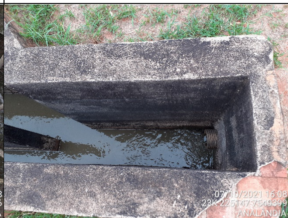
Foto 66: ETE – canal de entrada do efluente na Estação de Tratamento de Esgoto.
