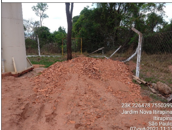
Foto 35: Pilha de material cerâmico dentro do terreno do poço 06 – SAA Morada do Sol.
