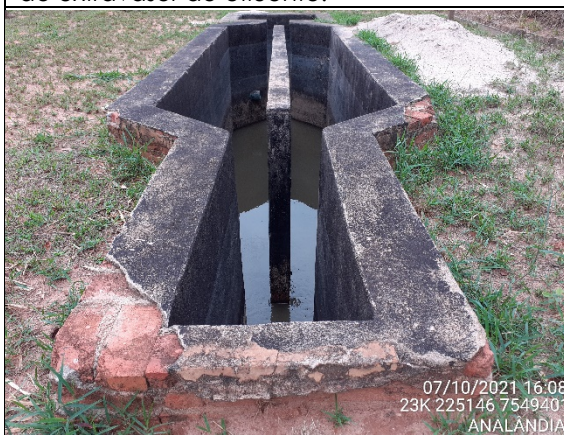
Foto 67: ETE – tanque de recepção.
