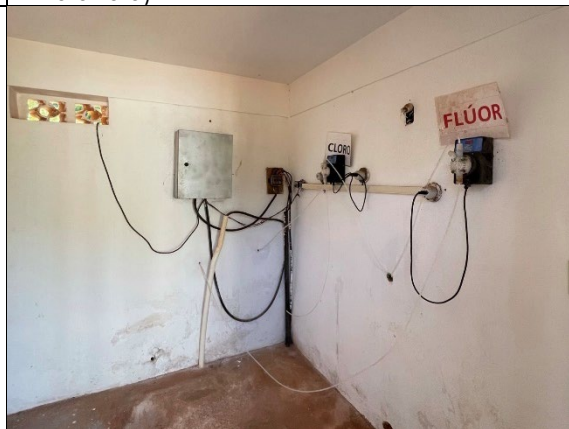
Foto 22: Bombas dosadoras de químicos - SAA Jardim Santana. (Fonte: Prefeitura Municipal de Analândia)
