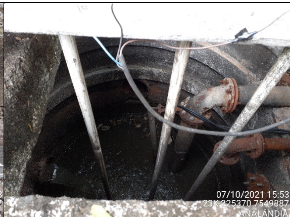
Foto 64: Estação Elevatória de Esgoto – poço da bomba de recalque.
