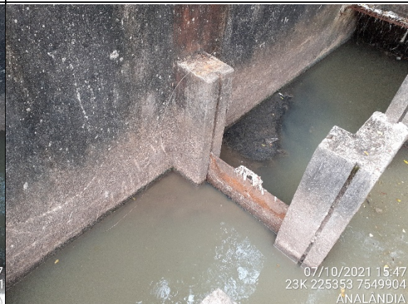
Foto 60: Estação Elevatória de Esgoto – divisão do canal de gradeamento do efluente para o canal de saída da caixa de areia.
