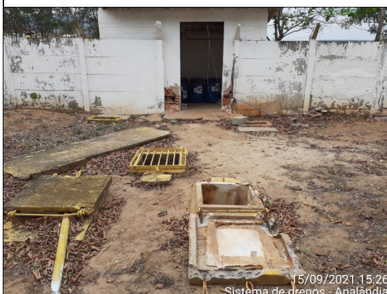
Foto 47: Vista da casa de químicos do SAA Drenos.
