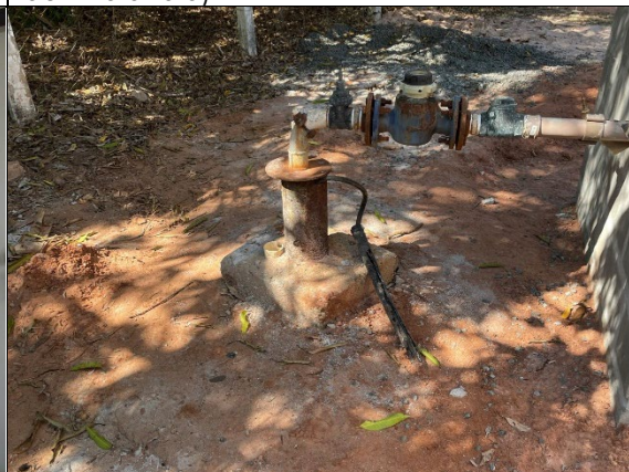
Foto 24: Laje Sanitária do poço 03 - SAA Jardim Santana (Fonte: Prefeitura Municipal de Analândia)
