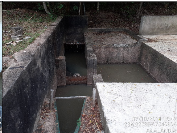
Foto 58: Estação Elevatória de Esgoto – grade ao fundo, caixa de areia à direita e calha Parshall mais à frente.
