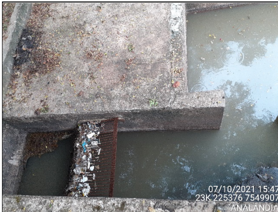
Foto 57: Estação Elevatória de Esgoto – Unidade de Gradeamento.
