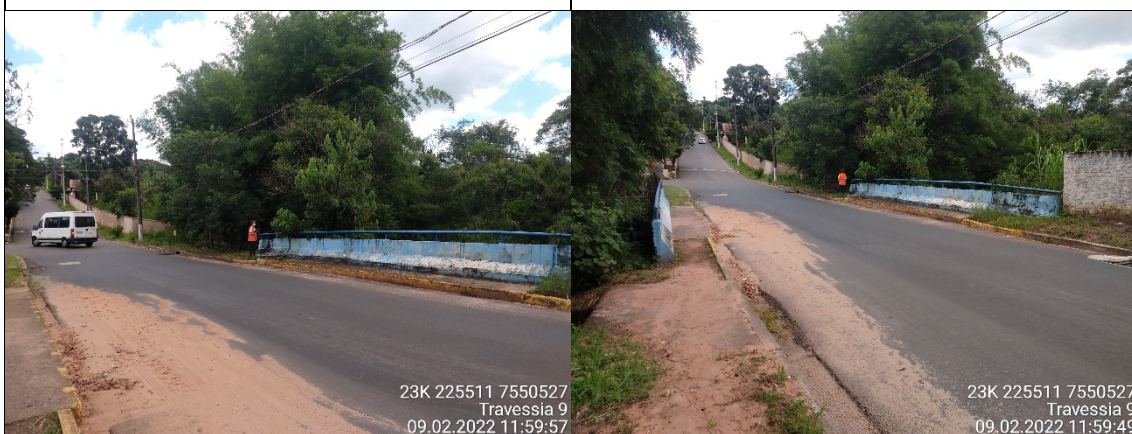
Foto 135: Assoreamento na Rua 6, próximo à Travessia 9.
