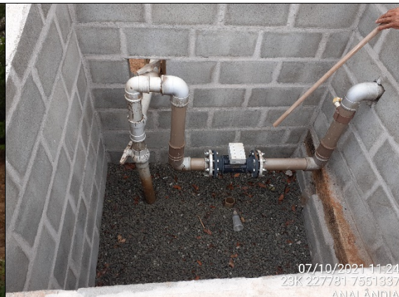
Foto 38: Macromedidor de vazão do poço 07 - SAA Portal das Samambaias.
