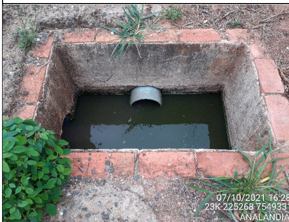
Foto 89: ETE - Caixa de saída do efluente da lagoa facultativa.
