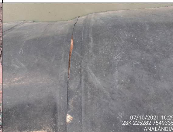
Foto 90: ETE - Presença de rasgos na lona de impermeabilização da lagoa facultativa.
