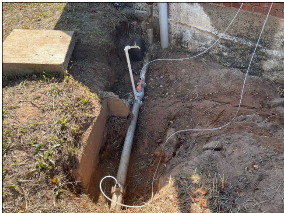
Foto 19: Conexões das mangueiras de adição de flúor e cloro do SAA Jardim São Carlos. (Fonte: Prefeitura Municipal de Analândia)
