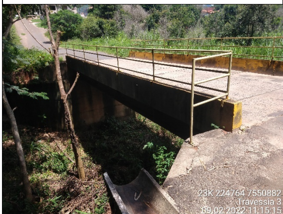
Foto 151: Travessia 3 – calha de água pluvial sem dissipador de energia.
