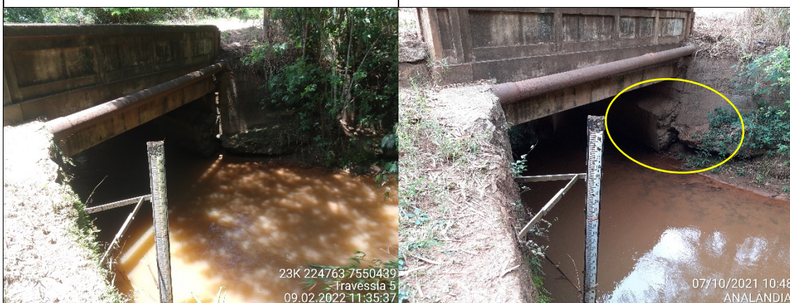
Foto 159: Travessia 5 – régua de medição do nível d'água (montante).
