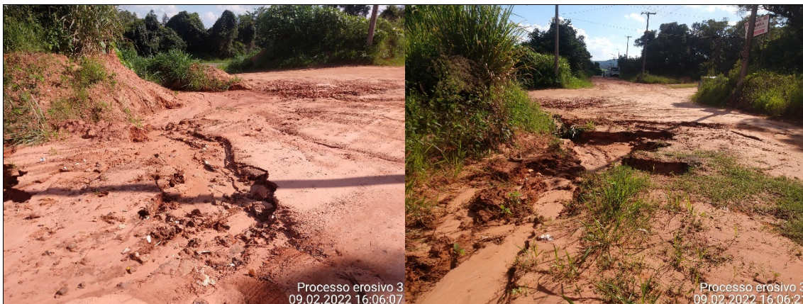
Foto 131: Processo erosivo na Avenida Marginal.
