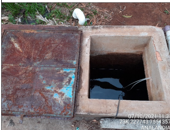
Foto 41: Mangueiras de adição de flúor e cloro em reservatório enterrado - SAA Portal das Samambaias.
